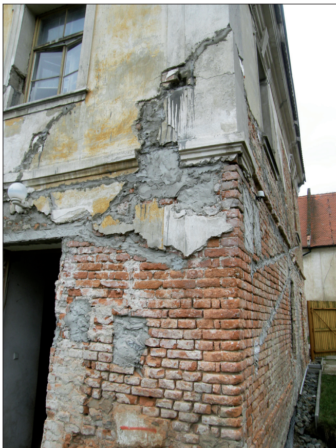
Obr. 4: Detail narušeného zdiva severovýchodního rohu budovy
