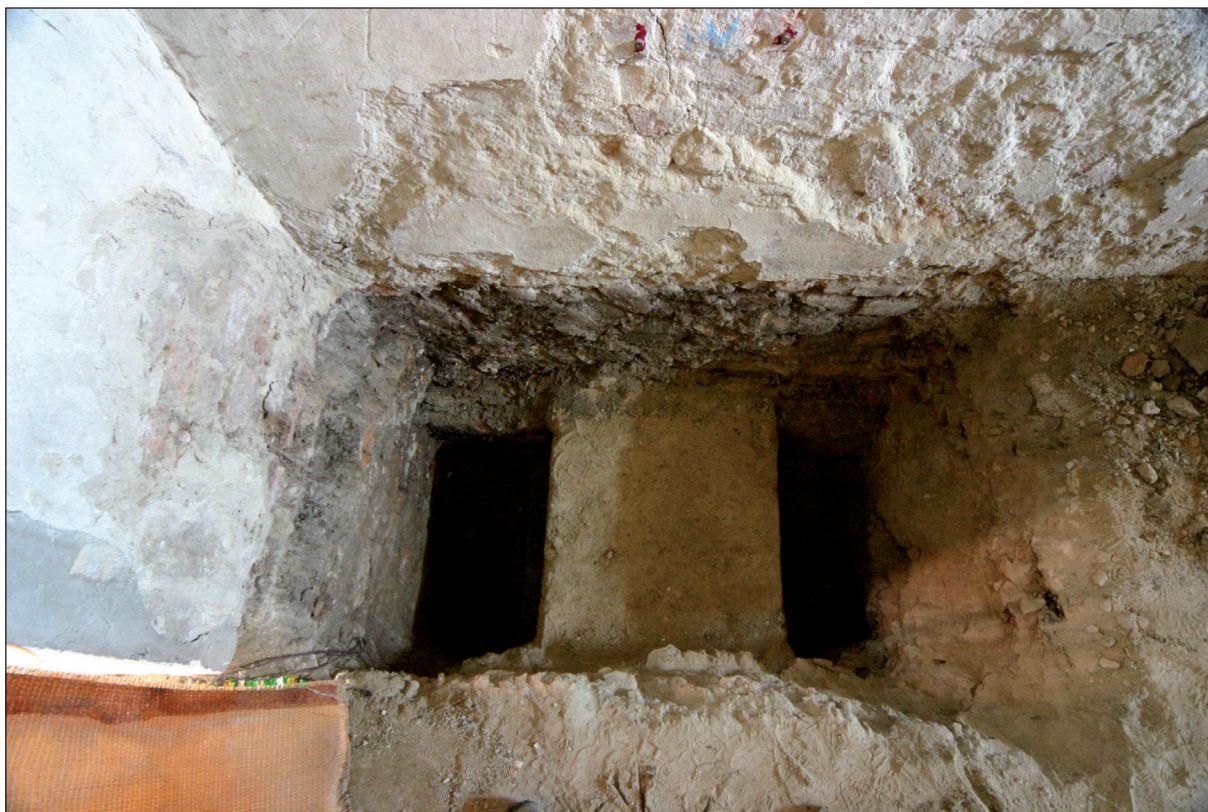
Obr. 9: Kopaná sonda u vnitřní podélné nosné zdi odhalila torzo původní střední zdi
