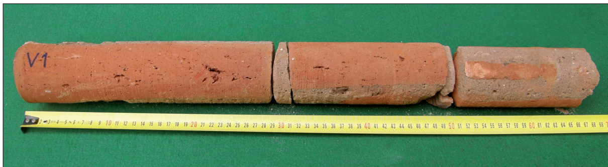
Obr. 10: Jádrový vývrt ze zdiva v oblasti porušeného severovýchodního rohu objektu. Vazba je velmi dobrá a ložné i styčné spáry jsou vyplněny maltou
