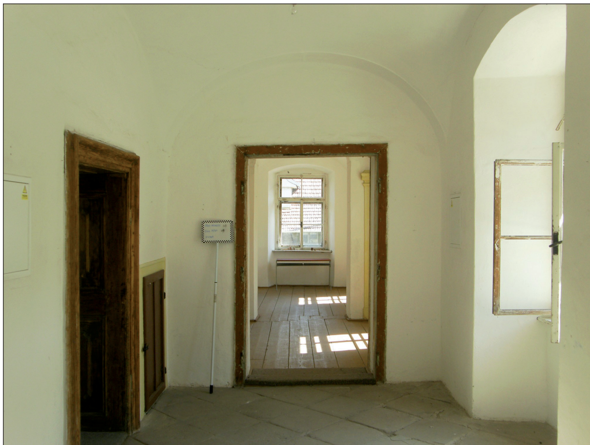
Obr. 6: Chodba ve 2.NP, na tvaru dveřního otvoru je patrný pokles vnitřní nosné zdi
